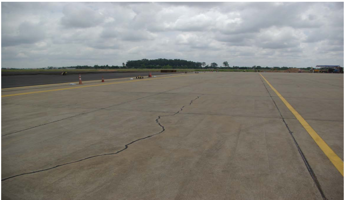
รูปที่ 2.5-2 ลักษณะรอยแตกของแผ่นคอนกรีตบริเวณลานจอดเครื่องบิน
