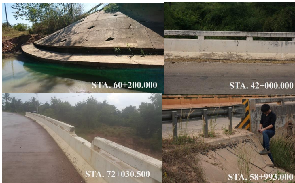
ภาพที่ 5.6-1 แสดงความเสียหายของสะพาน
